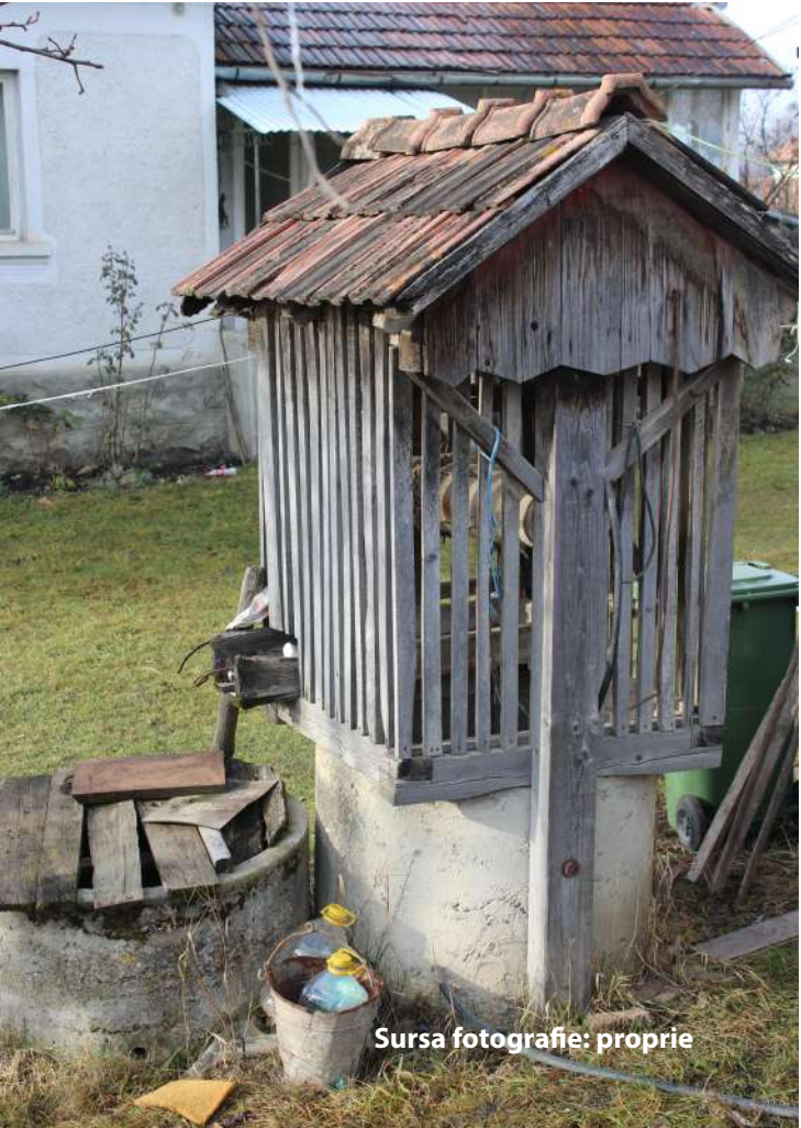
Fântână tradițională specifică satului, cu intervenții nepotrivite (soclu -inel din beton armat)
